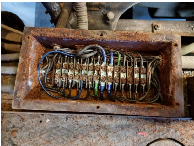
En koblingsboks var etablert fremme i motorrommet. Denne var sterkt preget av rustangrep. Foto: Jørgen R. Nøkleby
