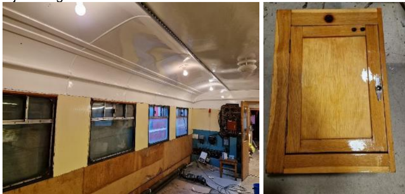
Arbeidene i kupe 1 skrider fremover. Tak, vegger og skap blir gått over. Foto: Morten Håland
