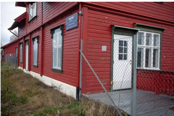
... løsning, drivhusglass. Glassene mot sporet har kommet på plass, endeveggen gjenstår. Vinduene vernes samtidig som bygningen ikke fremstår som stengt og fraflyttet.
